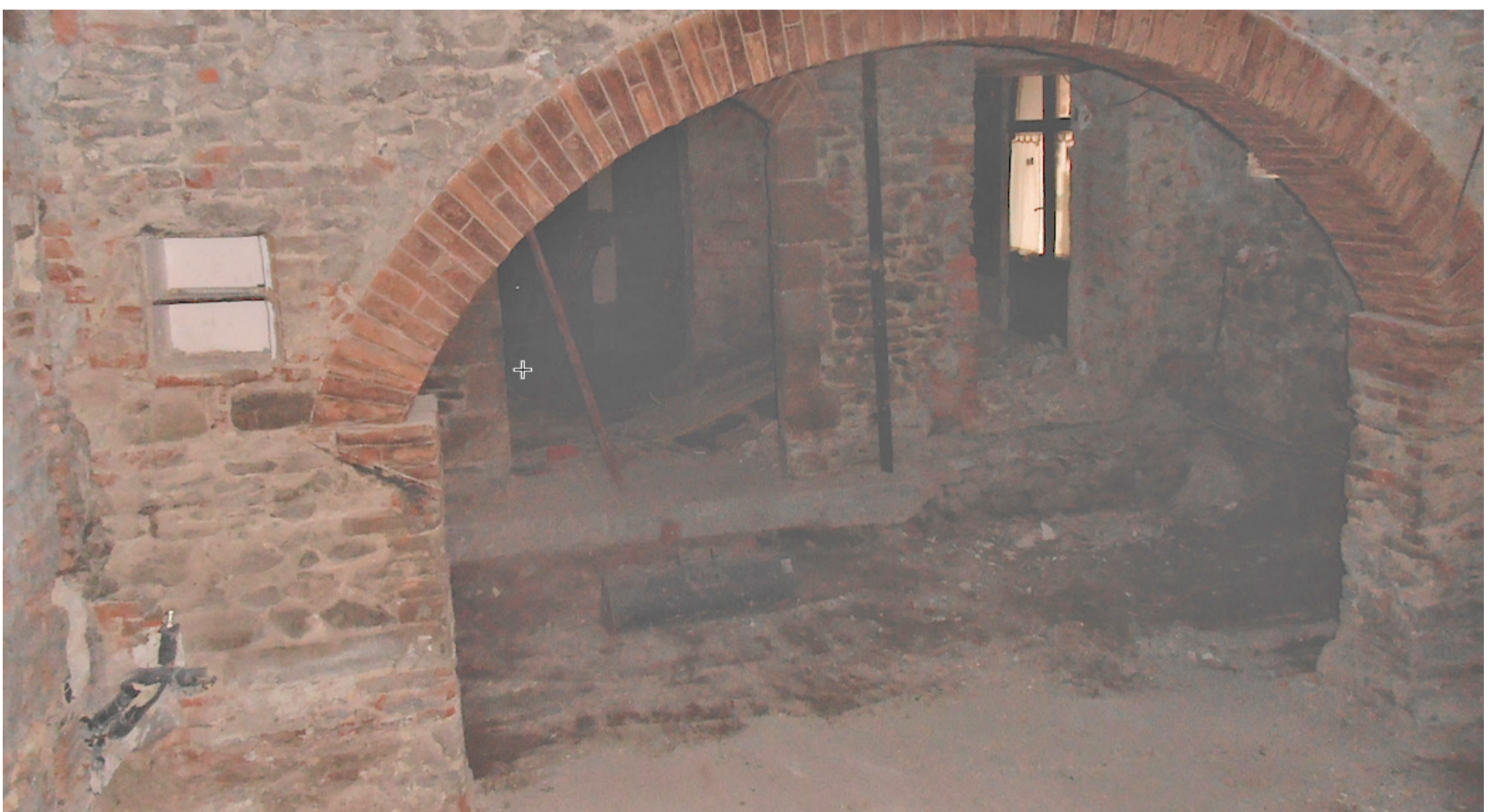
Particolare della saletta che era pavimentata in listelli di cotto: dopo aver distrutto il pregevole pavimento, lo scavo ha raggiunto le fondamenta
